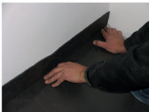
3 - Posizionare la fascia Latomuro lungo le partizioni verticali e tagliare nella lunghezza idonea.
